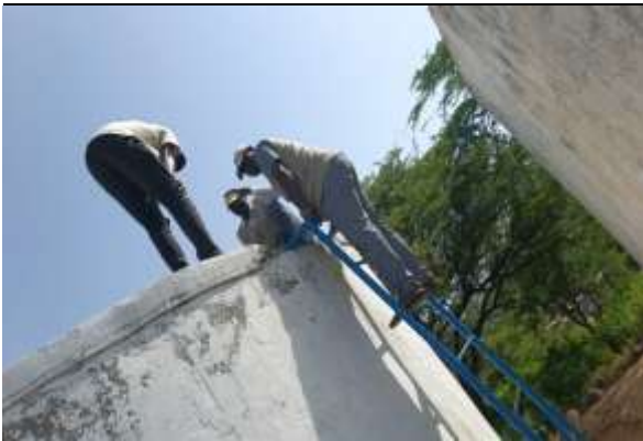
Image 7 : Traitement d'eau du château de Hadjer Hadid centre et Camp des réfugiés de Tredjine, 25 Septembre 2025
